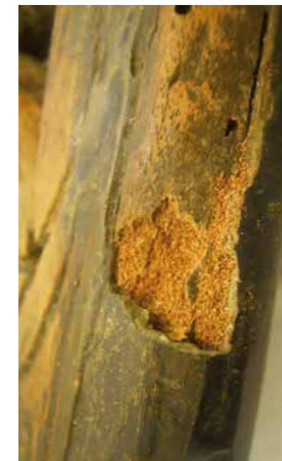
Degradació sota massilla.
